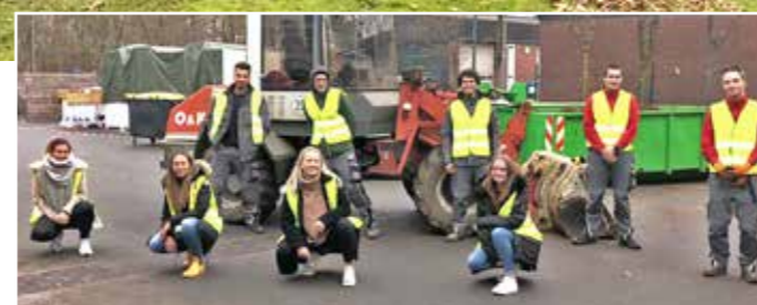
Projekt tiefergelegte Außenterrasse: Die Auszubildenden sind für die Gestaltung, Organisation und Realisierung verantwortlich. In regelmäßigen Abständen arbeiten die neun Auszubildenden an der Fertigstellung. Im Frühsommer sollen die Arbeiten abgeschlossen sein.
