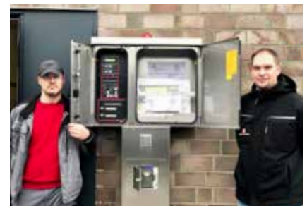
André Schnibbe (li) und Andreas Rüdibusch vor dem Feuerwehrübergabepunkt an der Außenwand.
