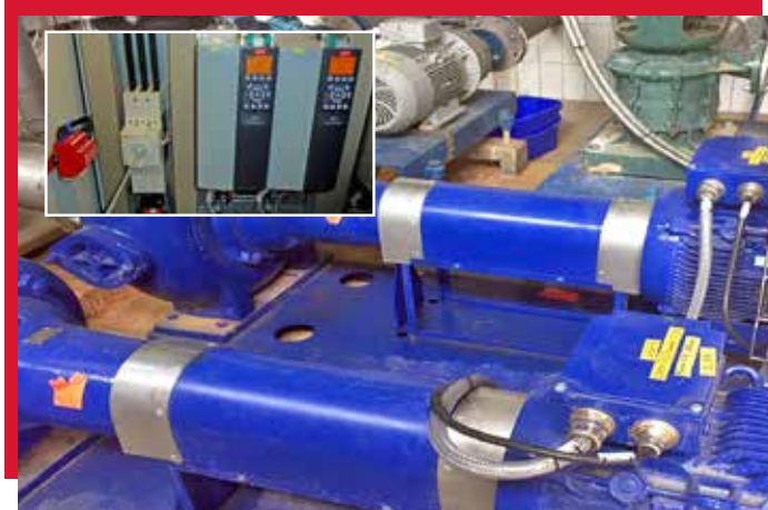
Im Bild das Pumpenhaus mit den Frequenzumformern, mit der die Drehzahl der Anlage geregelt wird (kleines Foto).
